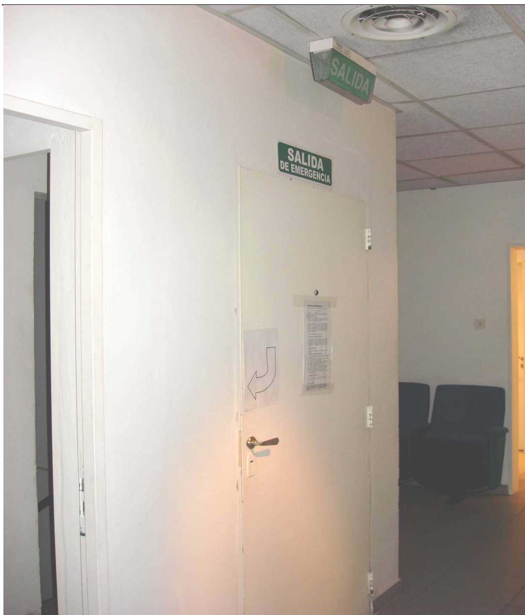
Foto Nº 6 – Vista en el 2º piso de una puerta abierta y a la derecha la salida de emergencia, por detrás se comunican entre si por otra puerta, es de notar que la salida de emergencia tiene que ser anti-pánico cosa que no ocurre en este caso, en la parte superior se encuentran dos carteles uno dice “salida” con luz y el otro “salida de emergencia”, los dos son coincidentes.
