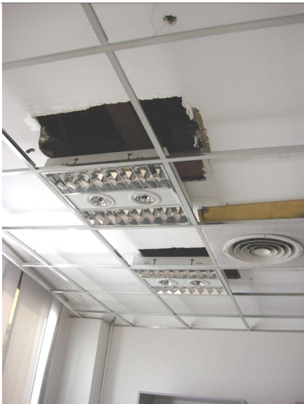
Foto N° 32 – Vista de otra oficina donde se pueden ver los efectos de las filtraciones de agua en el cielorraso.
