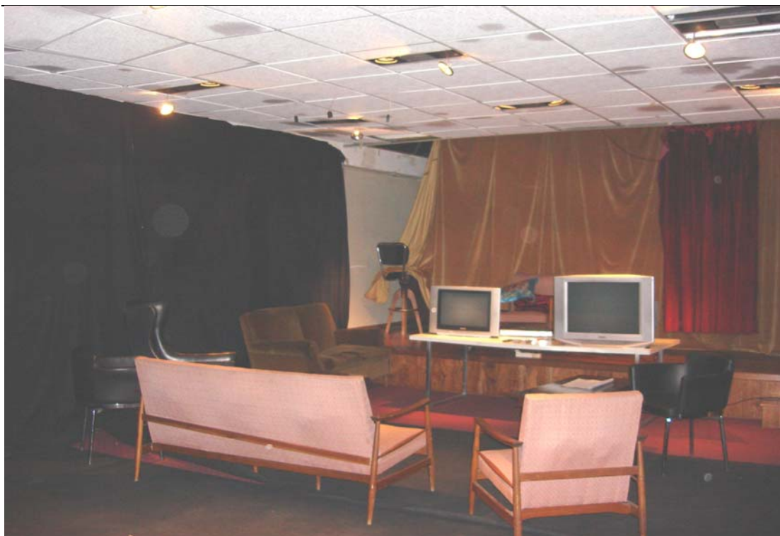
Foto N° 26 – Vista del auditorio, en el cielorraso se pueden observar varios artefactos de iluminación, algunos cuelgan de los cables de electricidad expuestos.
