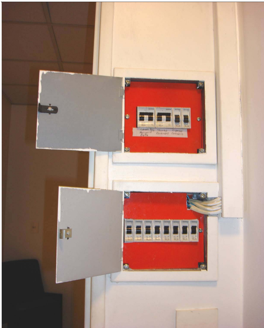
Foto Nº 24 – Vista de dos tableros de electricidad seccionales con llaves de corte térmicas.
