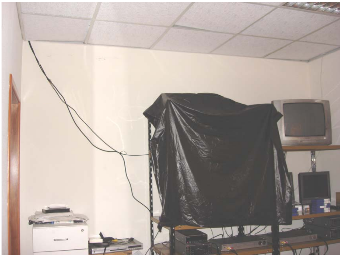
Foto N° 30 – Vista de la oficina de la derecha a la anterior, se puede apreciar que taparon los equipos técnicos con un plástico por la caída de agua del techo.
