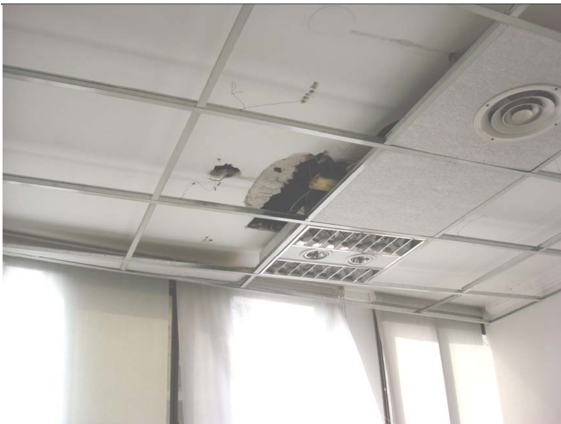
Foto N° 31 – Vista de otra oficina donde se pueden ver los efectos de las filtraciones de agua en el cielorraso.
