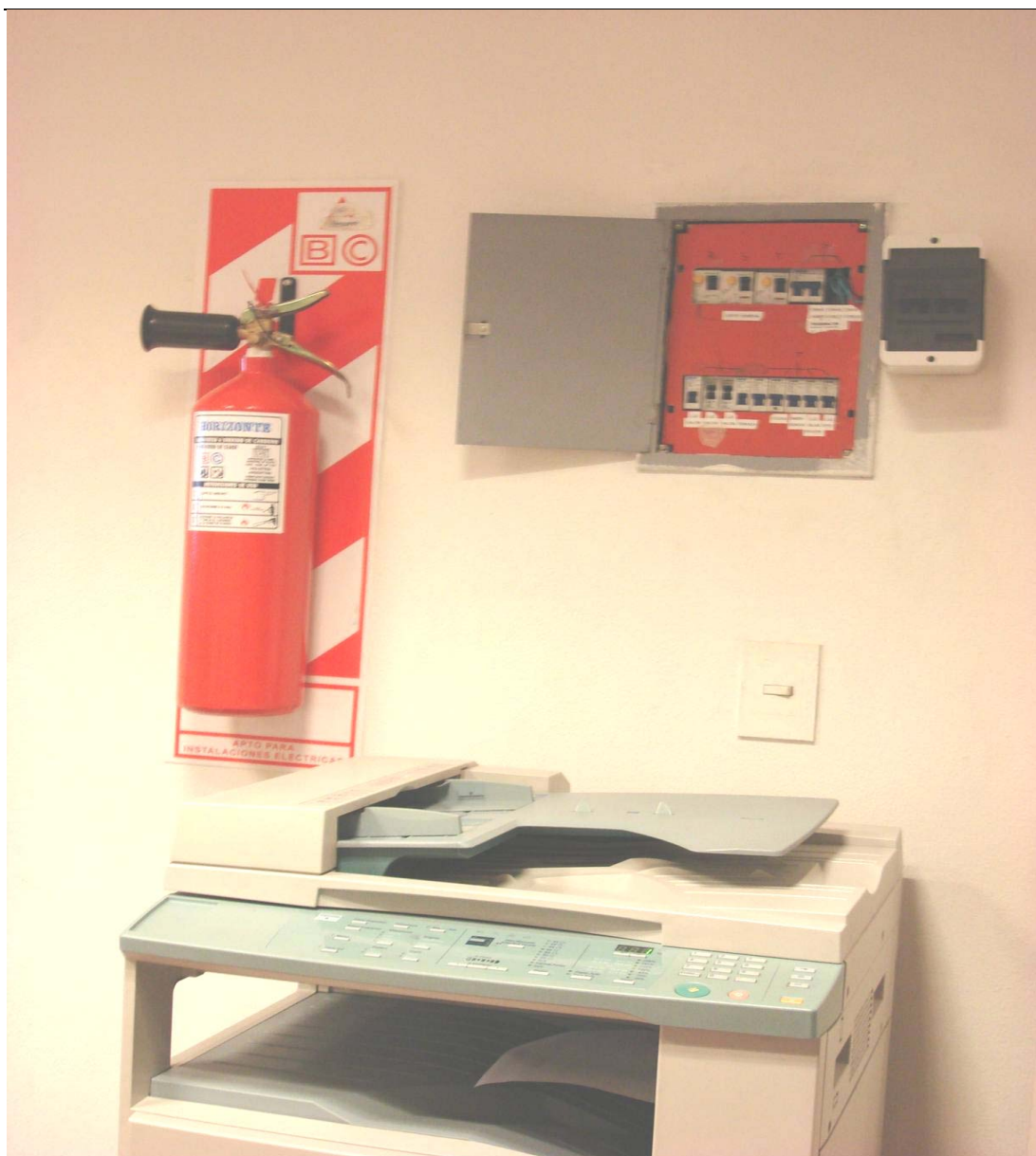
Foto N° 10 – Vista en el 2° piso un matafuego sobre la chapa reglamentaria, es de notar que este y todos los matafuegos de este piso, escalera y planta baja tienen la carga vencida desde junio del 2006, a la derecha se puede observar el tablero general de electricidad con llaves de corte térmicas y tres disyuntores de seguridad, uno para cada fase.
