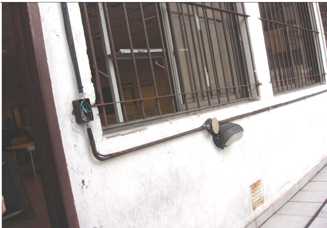
Foto N° 18 – Vista en la terraza del 2º piso la cañería de conductores eléctricos y una caja de derivación sin tapa y con los cables expuestos.
