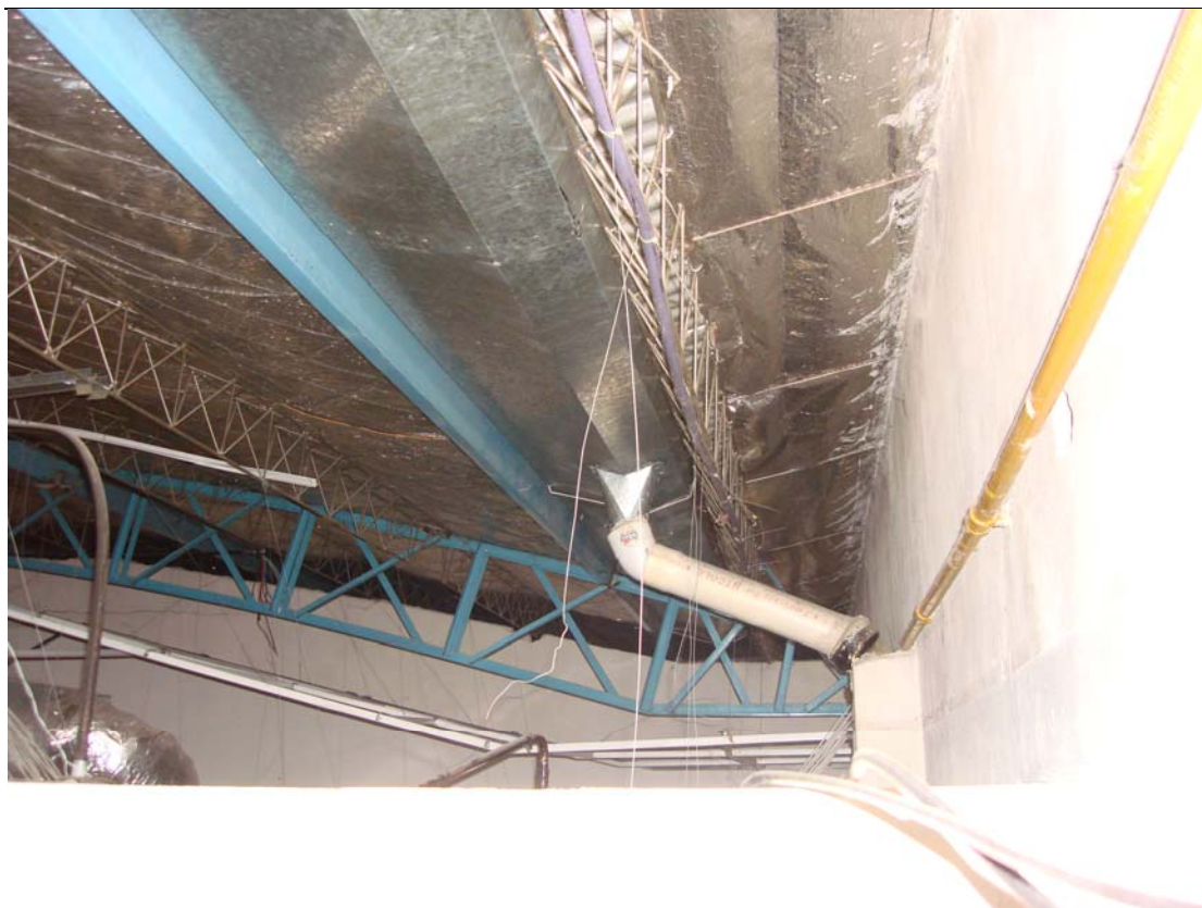
Foto N° 33 – Vista del espacio del sobretecho donde se puede apreciar la estructura del techo parabólico, la canaleta y uno de los caños del desagüe fuera de lugar.
