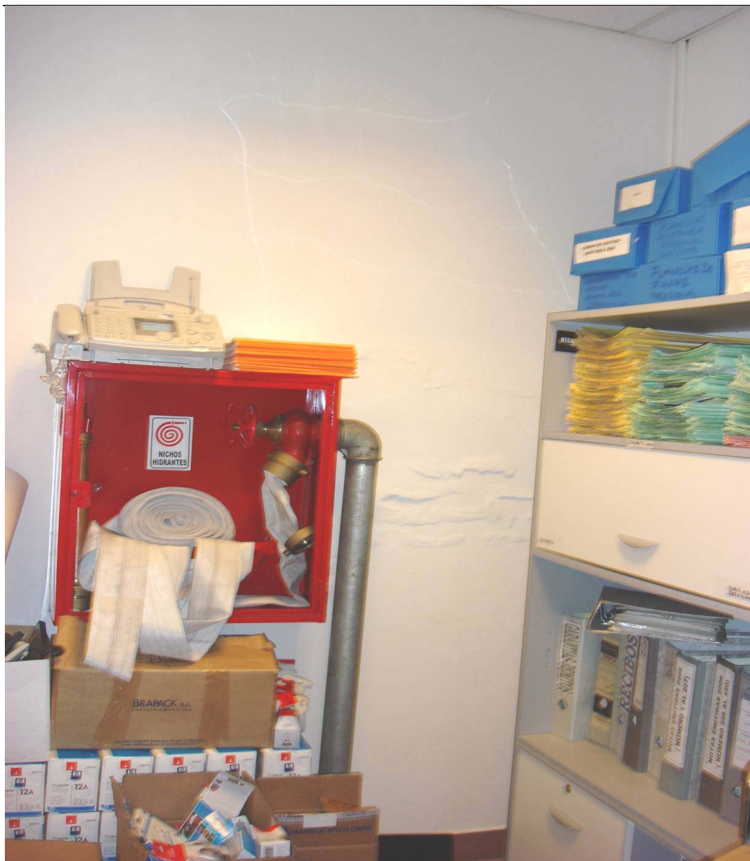
Foto Nº 14 – Vista en el 2º piso un gabinete de hidrantes con el vidrio roto y parte de la manguera fuera del mismo. En la pared se puede observar rastros de humedad que deterioraron el revoque y la pintura.
