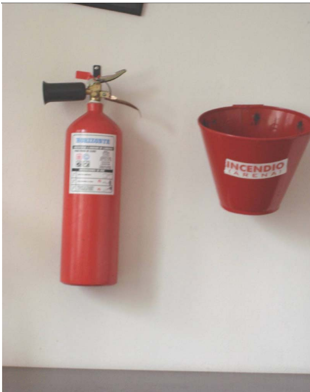
Foto N° 19 – Del sistema contra incendio observamos un matafuego con la carga vencida y un balde (sin arena) colocados en la pared.
