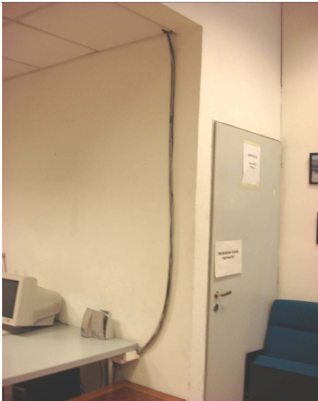
Foto N° 8 — Vista en el 2º piso, dentro de la dependencia del organismo los cables de alimentación de “sistemas” ubicados dentro de una vaina de plástico grueso transparente que bajan desde el sobretecho, esto se repite en todas las computadoras del piso.
