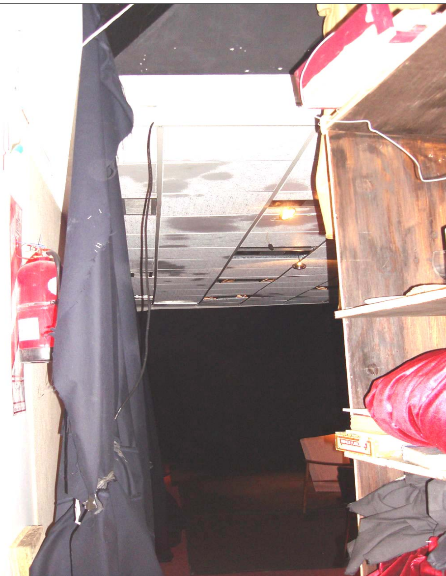
Foto N° 23 – Vista desde los probadores hacia el auditorio, a la izquierda se puede observar un matafuego sobre la chapa reglamentaria pero con la carga vencida. En el salón se pueden ver varios artefactos de iluminación uno de los cuales esta colgando de los cables de electricidad expuestos.
