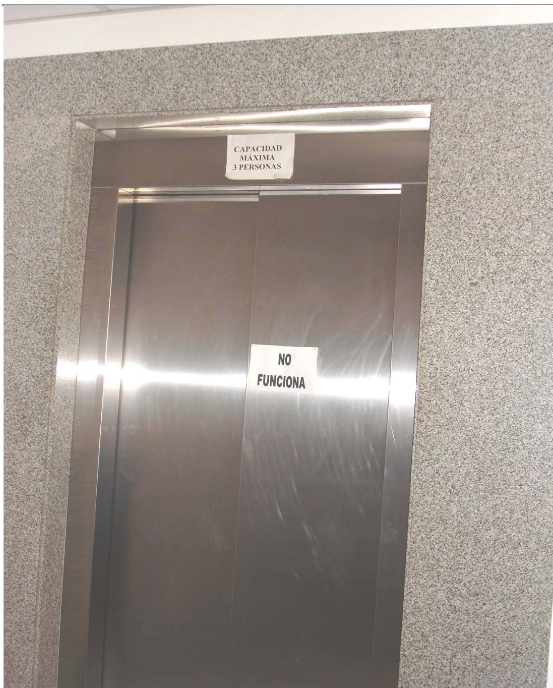
Foto N° 7 – Vista en el 2º piso de la puerta del ascensor con el cartel “no funciona”.
