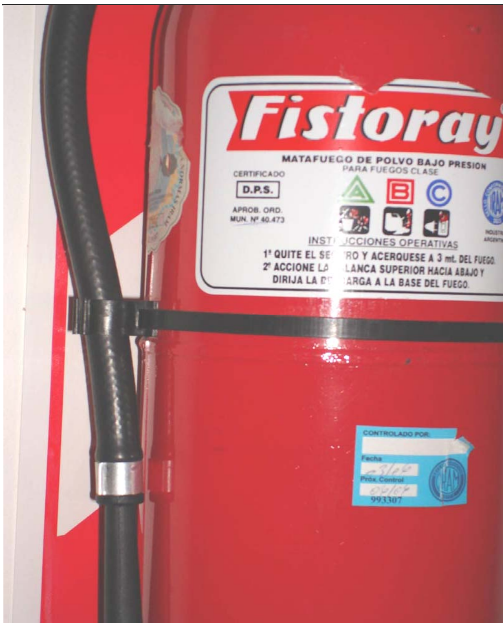
Foto N° 27 – Vista de uno de los matafuegos ABC con la fecha de vencimiento 06/06 en todos los demás aparatos observamos que algunos no tienen la tarjeta de vencimiento y el resto tienen la fecha antes mencionada.
