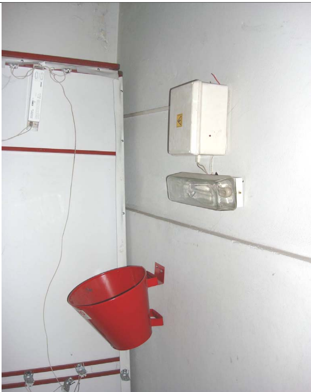
Foto N° 4 – Vista en la escalera de salida un balde colocado en la pared (sin arena) del sistema contra incendio, detrás apoyado contra la pared hay un panel de madera con circuitos eléctricos para uso en programas del canal, pero en la práctica son un obstáculo que en caso de incendio disminuyen el ancho de paso de esta salida, en la pared de la izquierda hay una luz de emergencia y la conexión eléctrica presenta cables expuestos.
