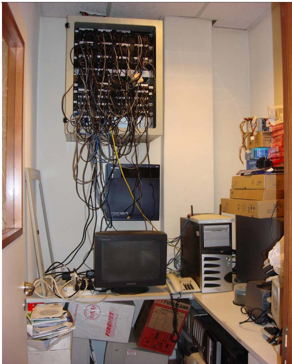
Foto N° 15 – Vista en el 2° piso un Server de sistemas, se puede observar gran desprolijidad en el cableado y elementos depositados que son ajenos a esa función.
