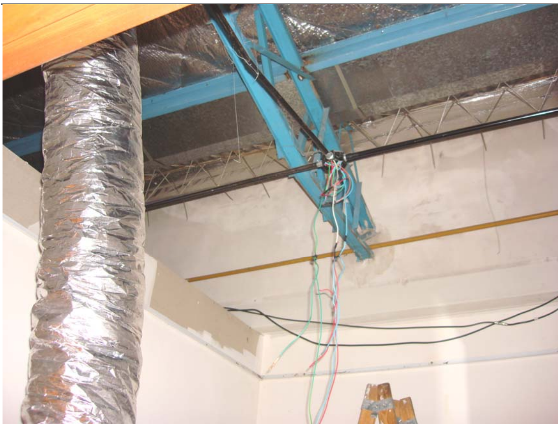
Foto N° 29 – Vista del sobretecho en una de las oficinas, donde quedan cables de electricidad expuestos y encintados.
